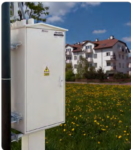
▲ Rozdzielnica stacyjna RS-5R opis produktu str. 63
