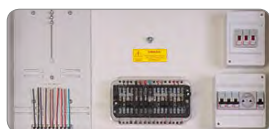
▲ Rozdzielnica stacyjna RS-5R+UPP
