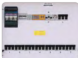
▲ Rozdzielnica stacyjna RS-5R+SOU
