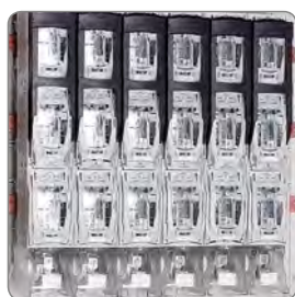
▲ Rozdzielnica stacyjna RS-5R opis produktu str. 63
